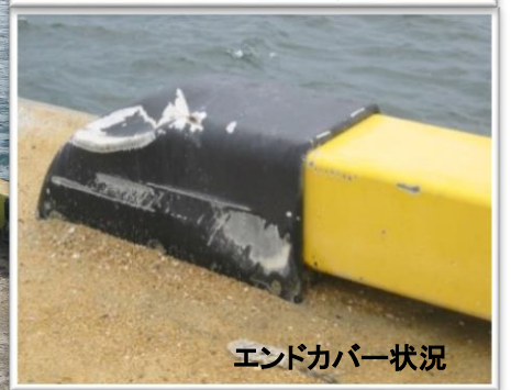
ジョイントカバー状況
