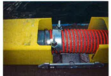
ジョイントカバー内部：給水管ジョイント部
