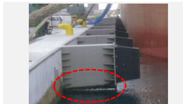
図 4.16 防舷材の鋼製の台座
