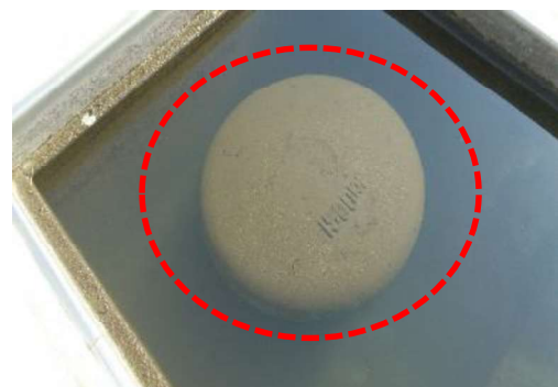
図 4.12 係船柱の箱抜きの中への設置（通常は通行に支障がないよう鋼製の蓋がされている）
