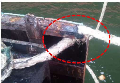
図 4.33 腐食した受衝板
