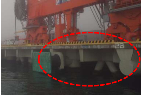
図 4.32 繋船ボートの潜り込み防止がない岸壁
