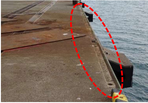
図 4.22 荷役作業のために撤去された車止め
