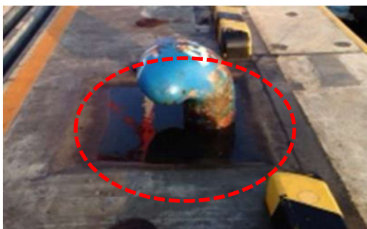
図 4.3 係船柱周りの段差②
