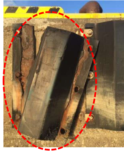
図 4.34 外れかかった防舷材
