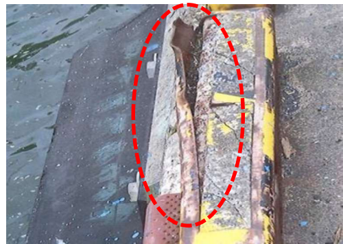
図 4.36 鋼材が腐食した車止め
