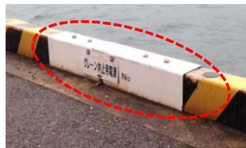
図 4.26 車止めと一体化した電源ボックス (安全性向上事例)
