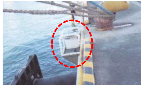
図 4.23 岸壁上や側面に突出した岸照灯
