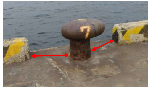
図 4.18 車止めの係船柱からの離隔
