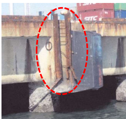
図 4.29 岸壁側面に突出したはしご
