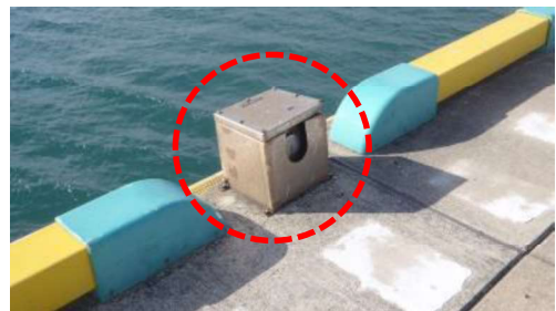
図 4.25 岸壁上に突出した電源ボックス
